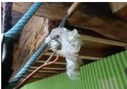
GAMBAR 2. SAMBUNGAN KABEL YANG TIDAK SESUAI DENGAN PUIL 2011
