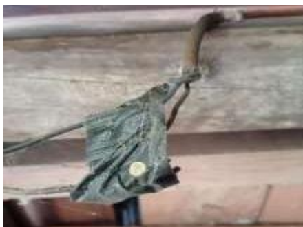
GAMBAR 3. PENGHANTAR YANG DIBUNGKUS DENGAN KANTONG PLASTIK TIDAK SESUAI PUIL 2011
